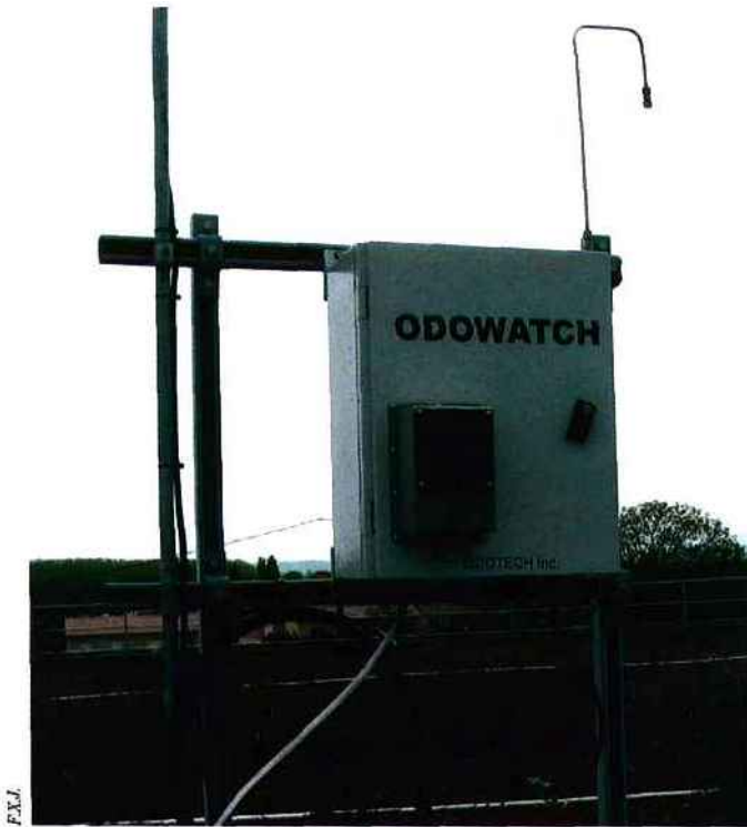
Chez Ferso-Bio, le nez électronique a été installé en sortie du biofiltre.
